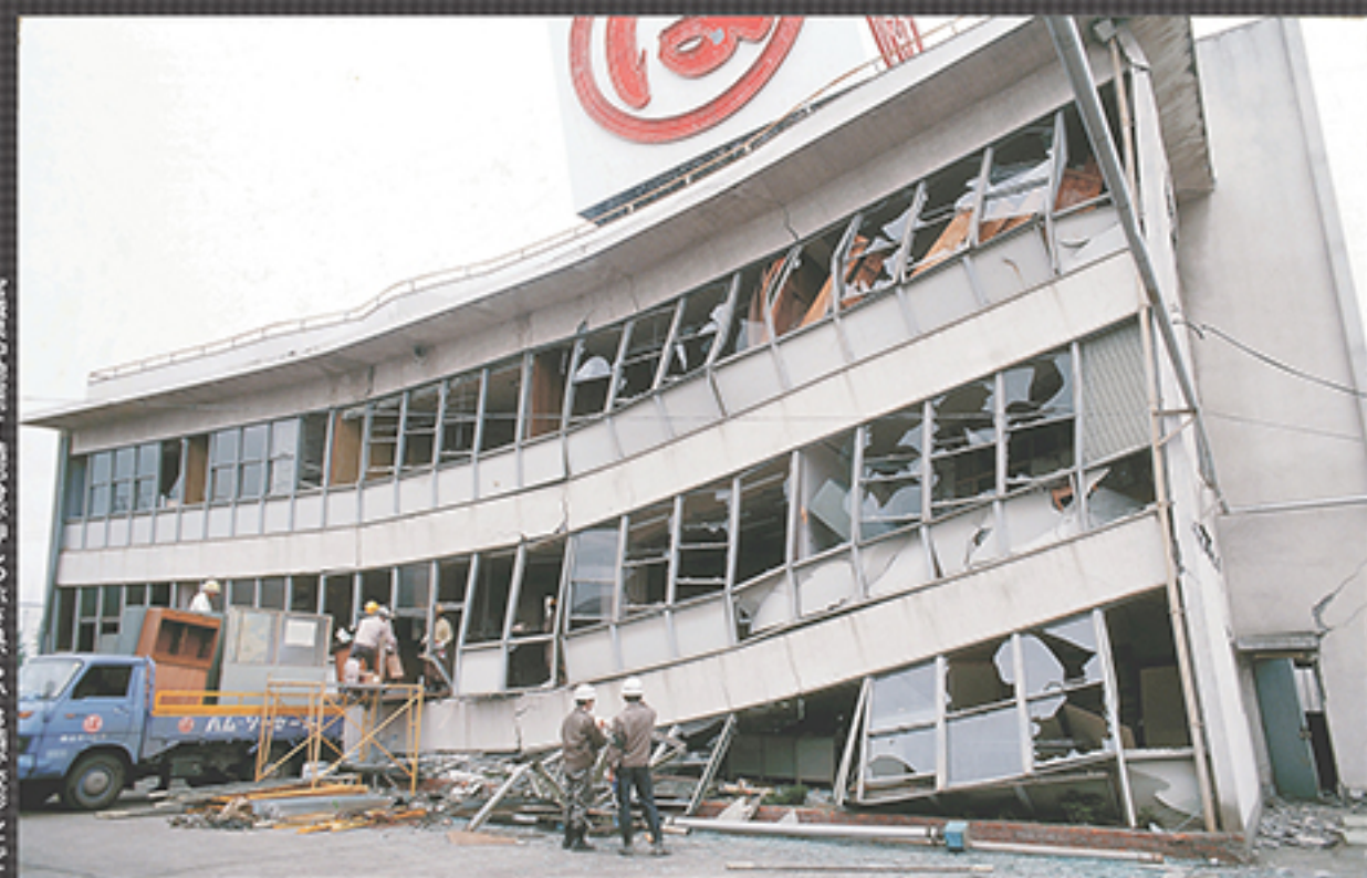
宮城県沖地震で1階部分が壊れ、2、3階が崩壊したビル。破文と彫られた建物が大きくゆがんだ。仙台市宮城野区宮野
