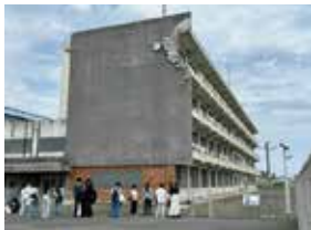
津波によって破壊された校舎の壁
