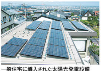
一般住宅に導入された太陽光発電設備
