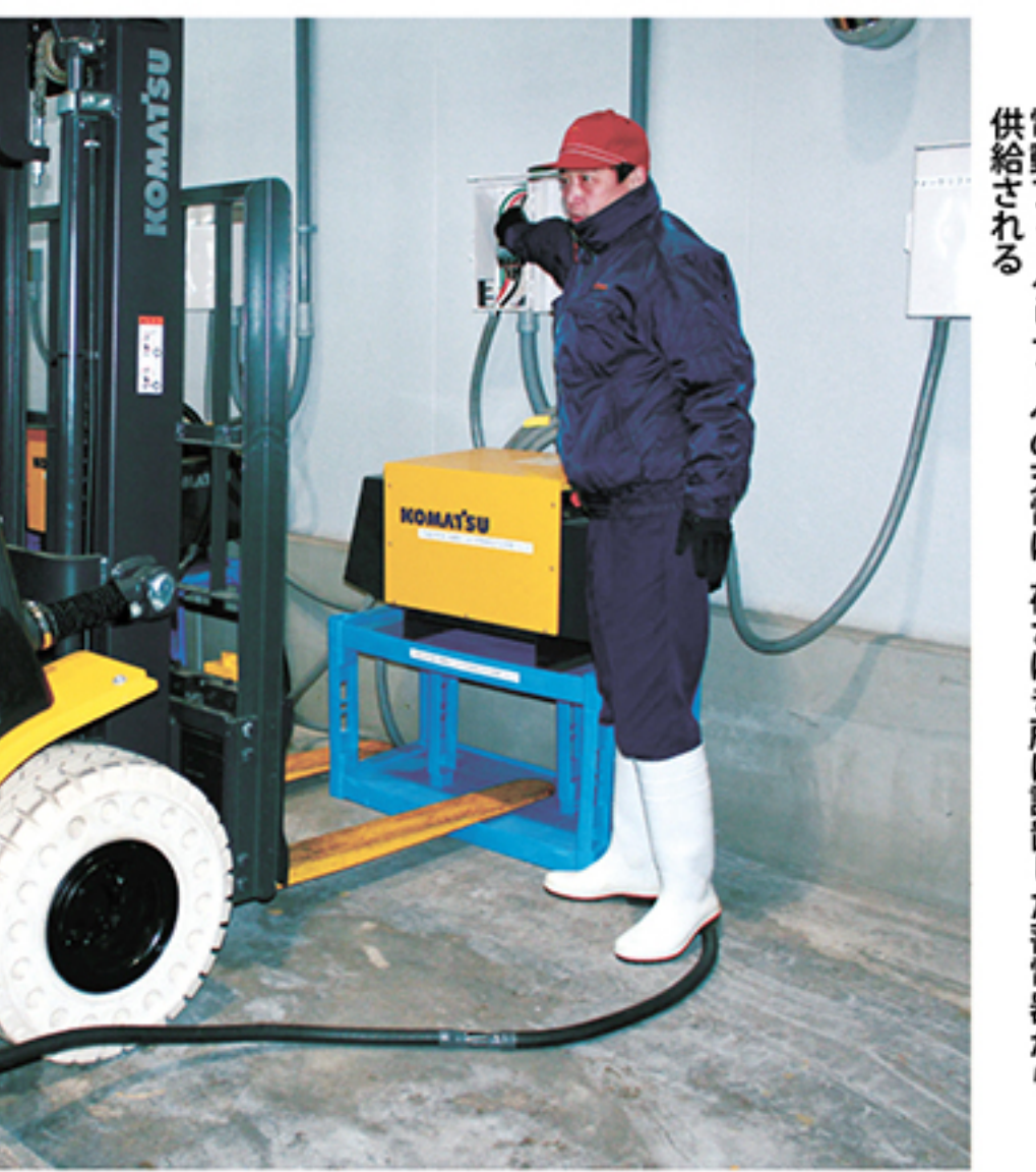
電動フォークリフトへの充電は、荷さばき所に設置した蓄電器から供給される。
