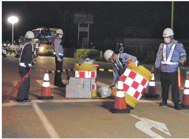
通行規制解除に向け、準備を進める作業員＝14日午後8時15分ごろ、福島県富岡町
