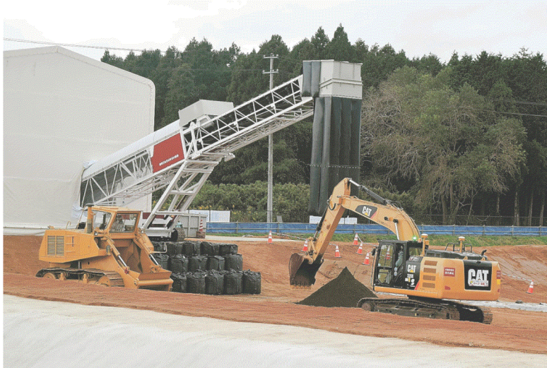
報道陣に公開された土壌貯蔵施設。ベルトコンベヤーを使って、施設に除染土が搬入された＝福島県大熊町大沢
