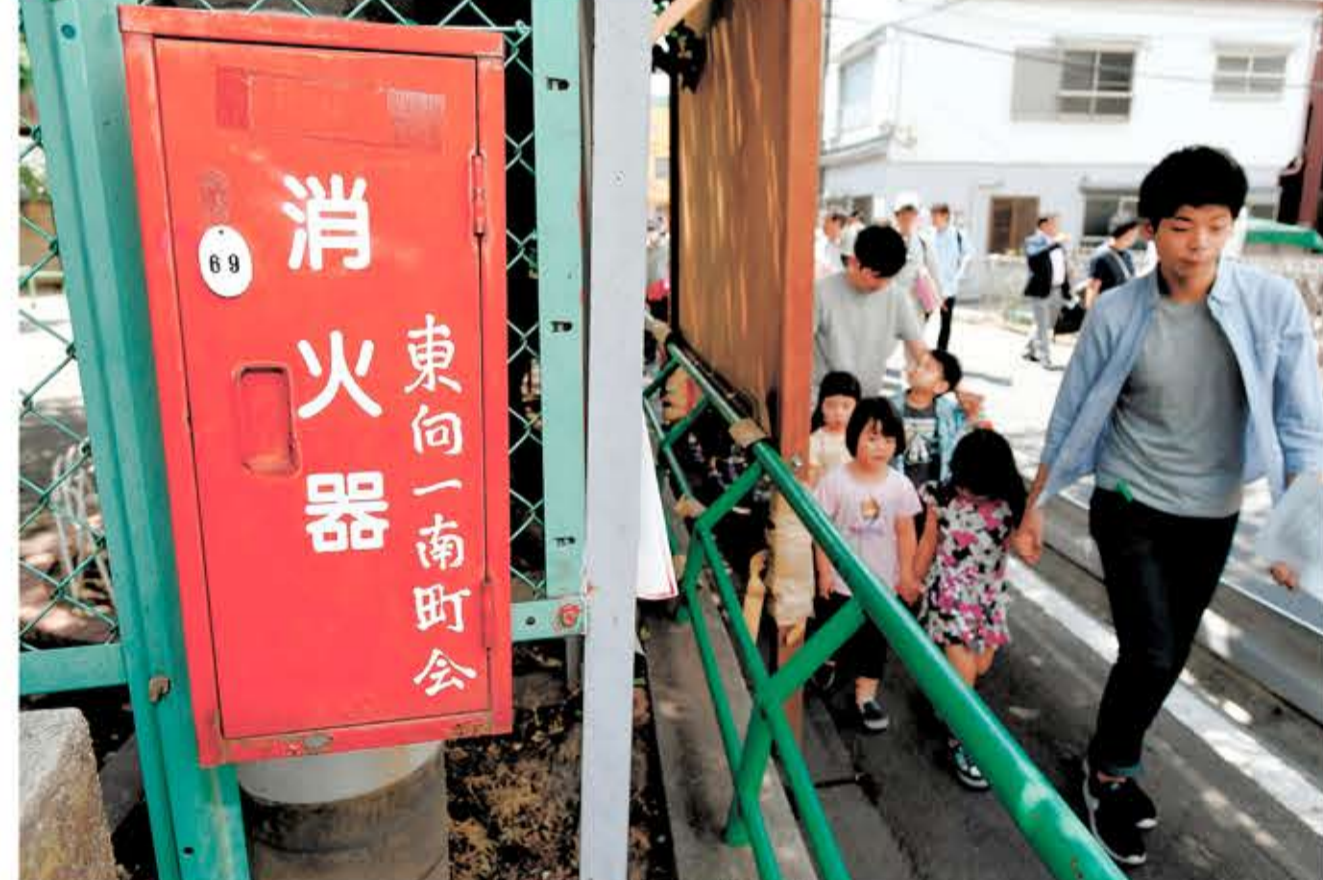
道沿いの至る所にある消火器
