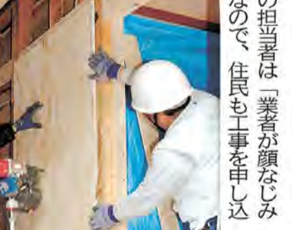
担当者は「業者が顔なじみなので、住民も工事を申し込むみて耐震が進んでいる」。
