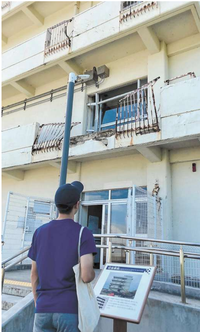
校舎2階ベランダの鉄柵は、津波の力で折れ曲がっていた＝8月13日、仙台市若林区
