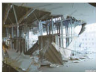
メディアテークの7階天井が落下 (写真・仙台市提供)
