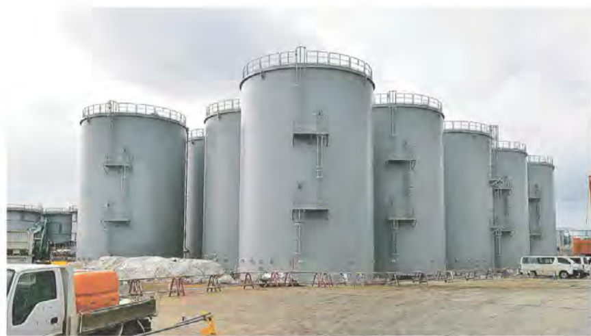
トリチウム水を貯蔵した大型タンクが並ぶ東京電力福島第1原発。汚染水の処分が大きな課題になっている=2月22日
